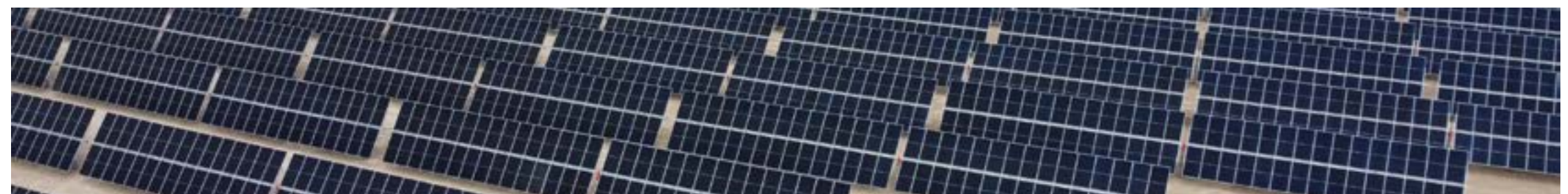
Planta solar en España, 5 MW.
