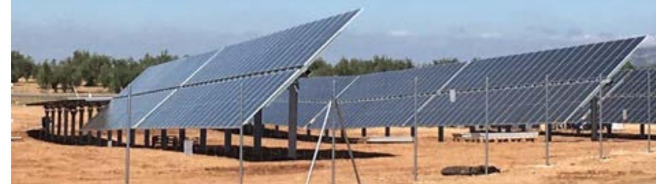
Planta solar en España, 5 MW.
