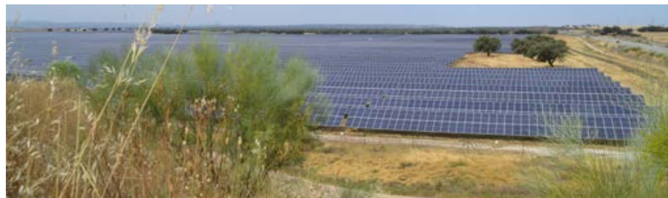
Planta solar en España, 300 MW.
