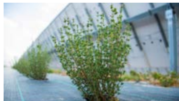
Planta solar en España, 85 MW.
