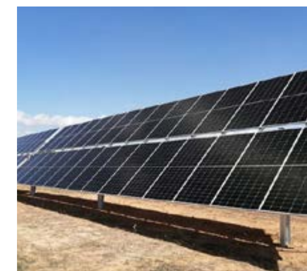
Planta solar en España, 5 MW.
