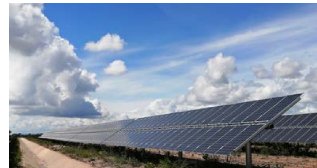
Planta solar en España, 5 MW.
