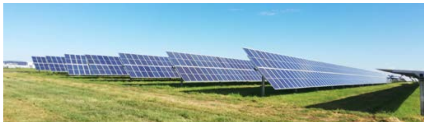
Planta solar en Australia, 70 MW.
