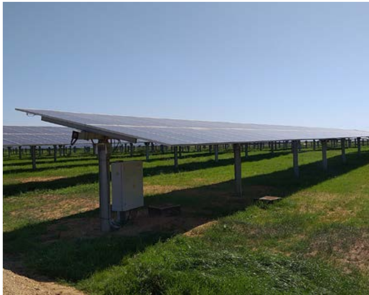
Planta solar en España, 50 MW.
