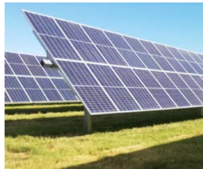
Planta solar en Chile, 78 MW.
