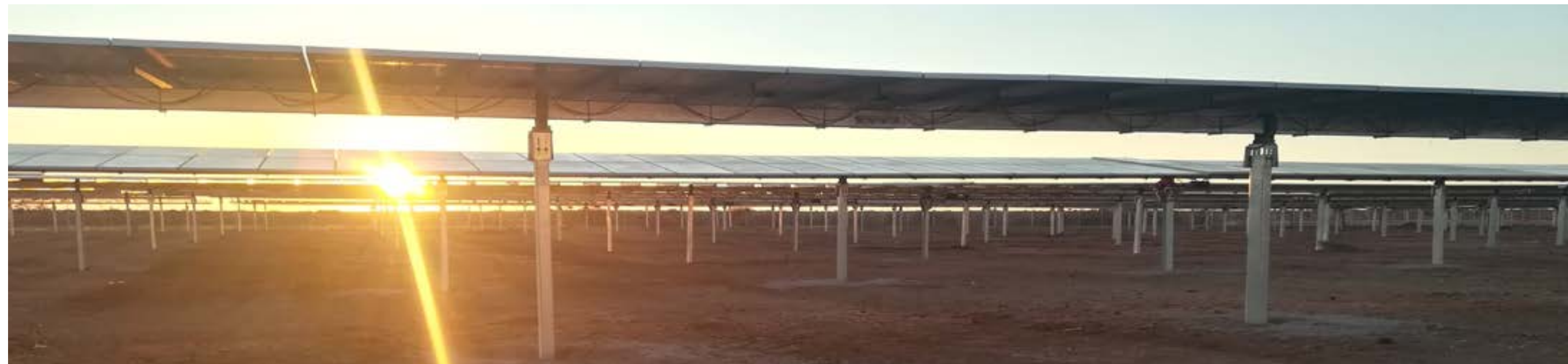
Planta solar en Namibia, 48 MW.
