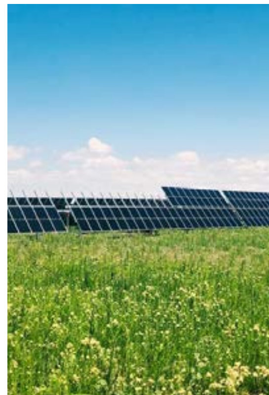
Planta solar en Chile, 11 MW.
