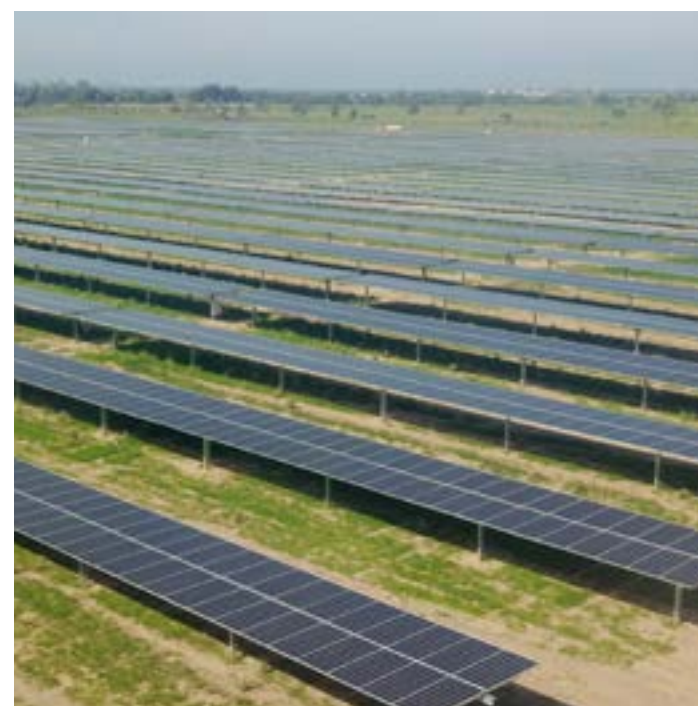
Planta solar en España, 50 MW.
