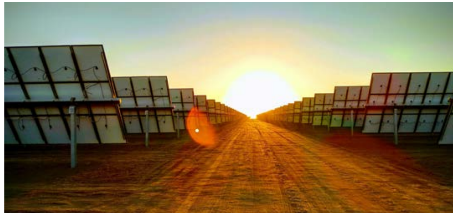
Planta solar en Brasil, 475 MW.
