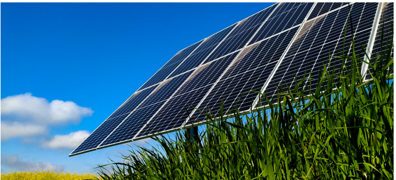
Foto: Planta solar en Chile instalada por Soltec.
