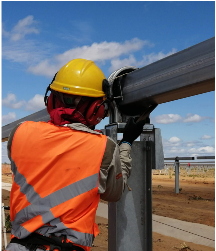
Foto: Instalación de un seguidor solar Soltec.
